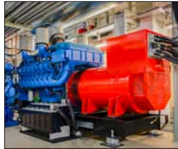
Abb. 1: Drehstromgenerator mit Dieselantrieb
