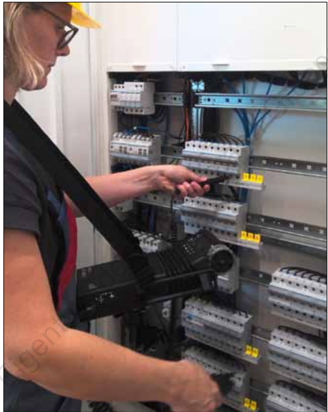
Abb. 1: Prüfung einer elektrischen Anlage
