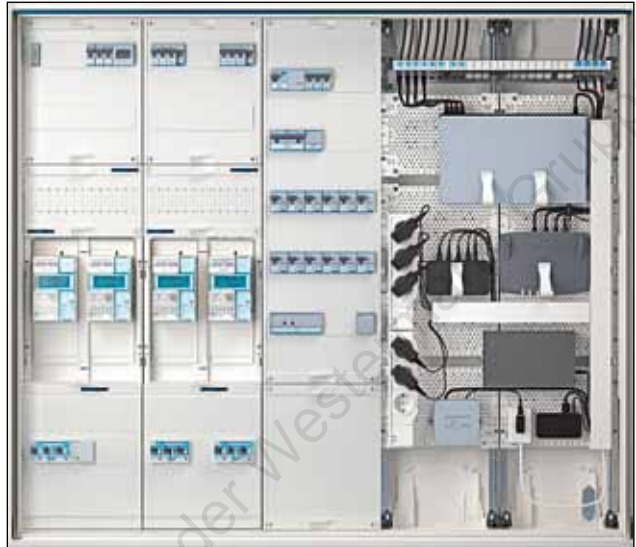
Abb. 1: Zählerschrank mit Verteilerfeld und Kommunikationsverteiler (Einfamilienhaus)
